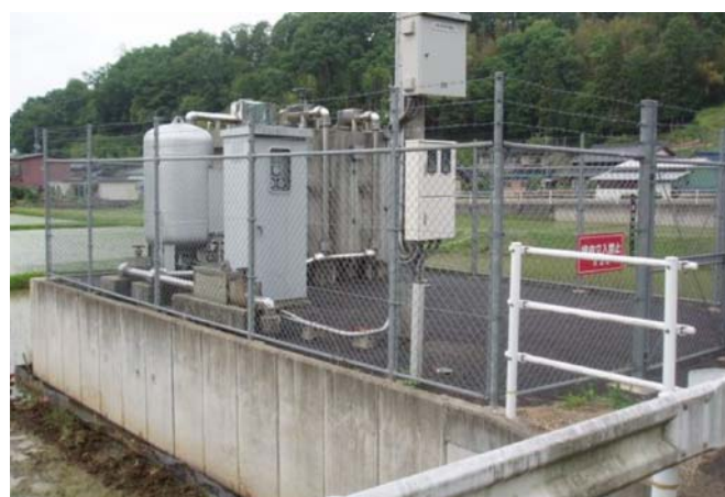
下飯田加圧ポンプ所
